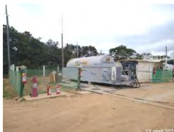
Foto 72 – Posto de abastecimento de combustível. (Data:13/04/2021)
