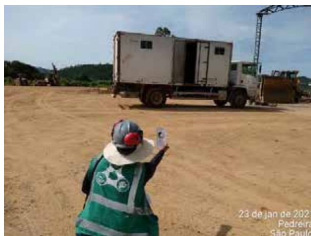
Foto 392 – Monitoramento de fumaça preta no caminhão oficina. (Data:23/01/2021)
