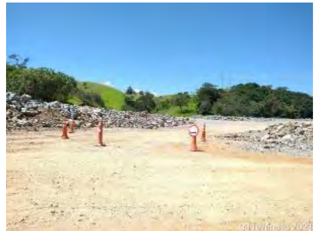
Foto 260 – Sinalização de sentido de via obrigatório em via interna na margem direita. (Data:03/02/2021)
