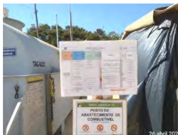
Foto 116 – LAI disponível no posto de abastecimento. (Data:26/04/2021)
