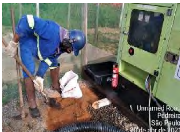
Foto 73 – Acionamento do plano de contingência em vazamento do gerador. (Data:20/04/2021)
