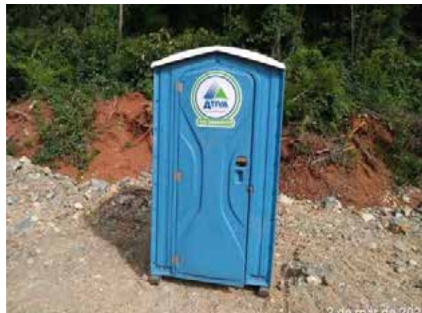
Foto 372 – Banheiro químico instalado na frente de serviço – bota-fora II M.E.. (Data:02/03/2021)
