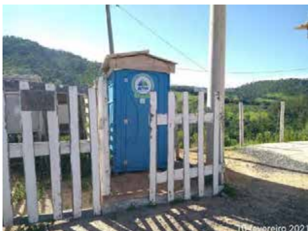
Foto 369 – Banheiro químico feminino instalado na frente no canteiro operacional. (Data:10/02/2021)
