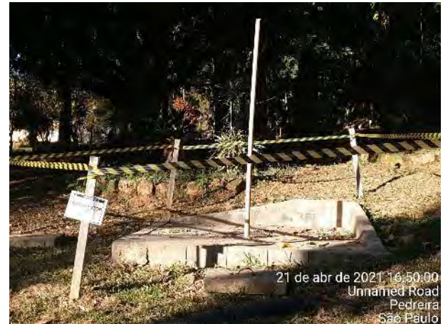
Foto 378 – Biodigestor 02 - canteiro administrativo. (Data:21/04/2021)
