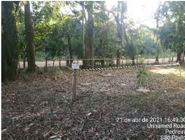
Foto 377 – Biodigestor 01 - canteiro administrativo. (Data:21/04/2021)
