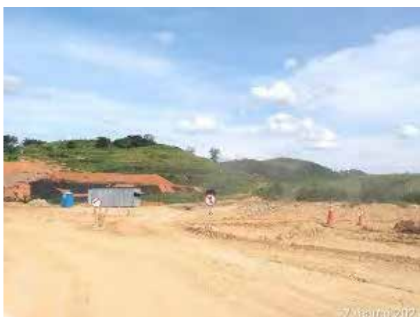
Foto 267 – Sinalização em via interna. (Data:17/03/2021)
