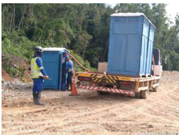
Foto 373 – Higienização do banheiro químico na frente de serviço. (Data:02/03/2021)
