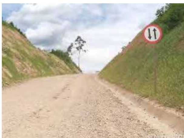
Foto 249 – Sinalização de sentido de via dupla no acesso da MD01. (Data:03/03/2021)
