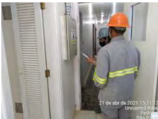
Foto 153 – Inspeção em quadro de força. (Data:21/04/2021)
