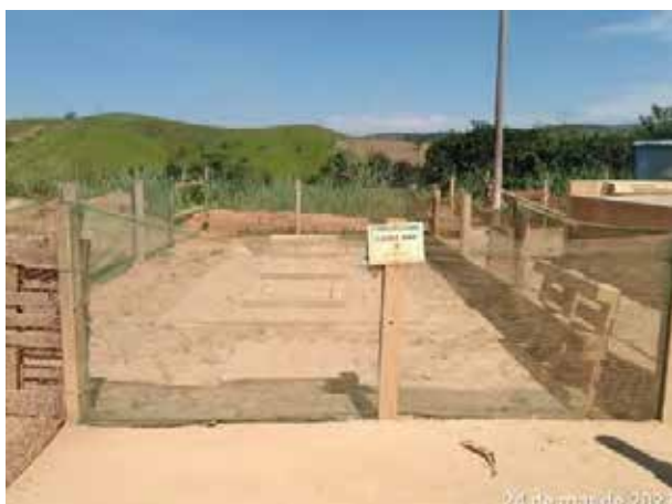
Foto 359 – Caixa separadora de água/óleo 2 na área da oficina mecânica. (Data:24/03/2021)
