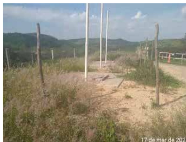
Foto 376 – Sistema de fossa séptica no canteiro operacional. (Data:17/03/2021)
