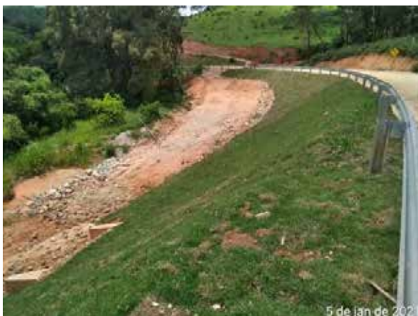
Foto 299 – Inspeção em talude gramado no acesso MD03 gramado na margem direita. (Data:05/01/2021)
