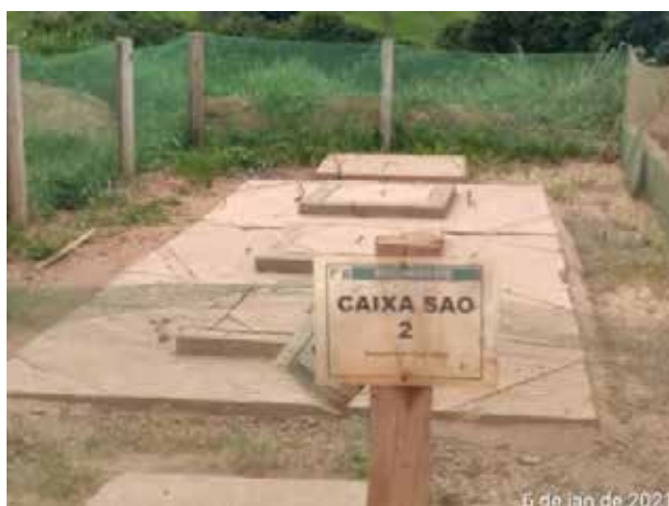
Foto 353 – Caixa separadora de água/óleo. (Data:06/01/2021)
