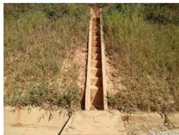
Foto 292 – Escada hidráulica no acesso MD01. (Data:26/04/2021)
