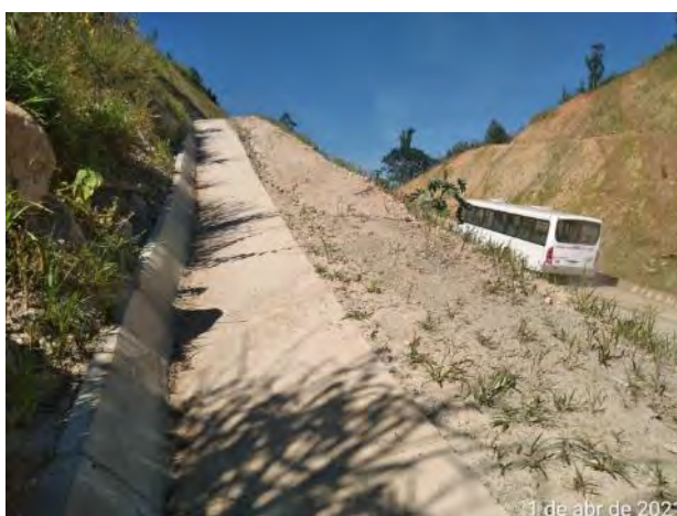
Foto 297 – Canaleta de crista em talude do acesso MD03. (Data:01/04/2021)
