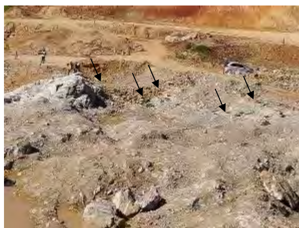
Foto 136 – Reaproveitamento de capa de fardo de hidrosseadura para sinalização de segurança dos explosivos do desmonte e rochas. (Data:27/01/2021)
