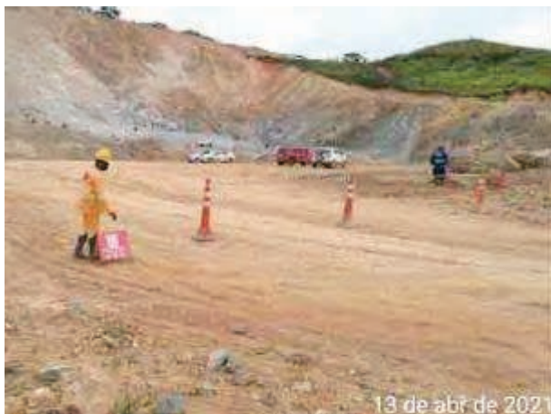
Foto 171 – Sinalização de segurança na área de carregamento de explosivos para o desmonte de rochas. (Data:13/04/2021)
