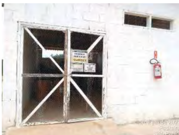
Foto 63 – Baia de resíduos perigosos no canteiro operacional. (Data:13/01/2021)
