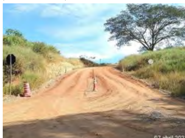
Foto 252 – Sinalização de cones e placa de limite de velocidade na estrada municipal de pedra. (Data:07/04/2021)
