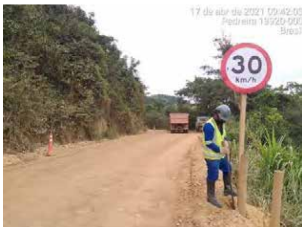
Foto 271 – Instalação de placa com velocidade máxima permitida em via interna. (Data:17/04/2021)
