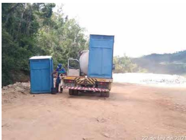
Foto 371 – Higienização do banheiro químico na frente de serviço (Data:22/02/2021)
