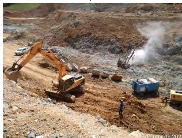
Foto 450 – Movimentação de terra e rocha na área do eixo na margem direita. (Data:09/03/2021)
