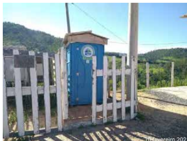
Foto 370 – Banheiro químico feminino instalado na frente no canteiro operacional. (Data:10/02/2021)
