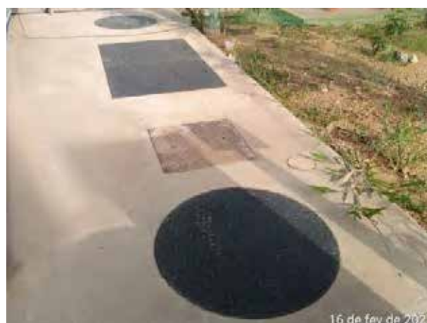
Foto 358 – Caixa separadora de água/óleo 1. (Data:16/02/2021)
