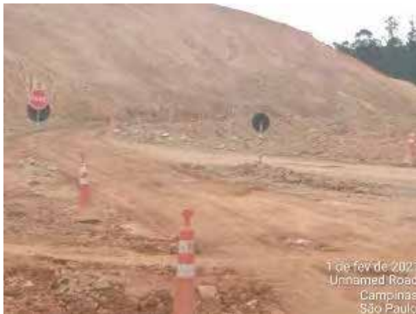
Foto 259 – Sinalização de pare em via interna na margem esquerda. (Data:01/02/2021)
