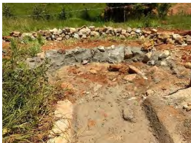
Foto 284 – Dispositivo dissipador de água pluvial no acesso MD03. (Data:10/02/2021)
