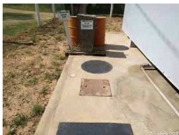
Foto 362 – Caixa separadora de água/óleo 1 do posto de abastecimento. (Data:26/04/2021)
