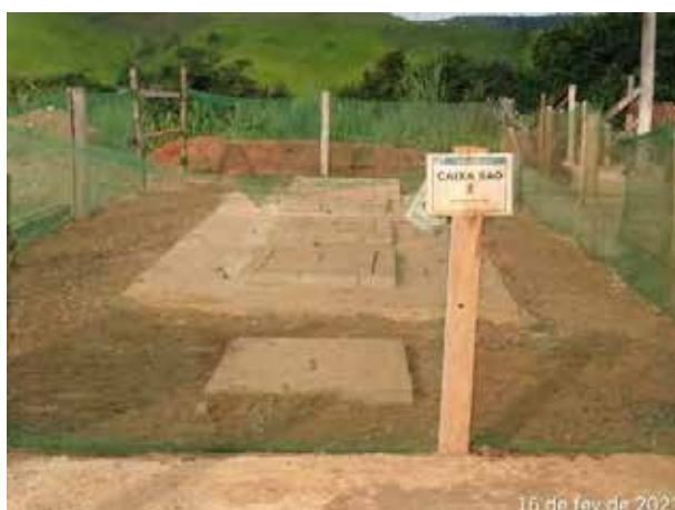
Foto 357 – Caixa separadora de água/óleo 2 na área da oficina mecânica. (Data:16/02/2021)
